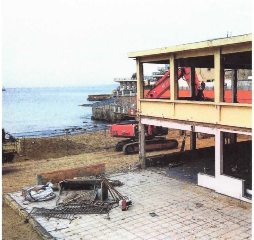
Les travaux ont commencé hier matin à coups de pelleteuses mécaniques et de pioches. Ils devraient s'achever en juin prochain, bien que de nombreux aménagements soient encore à prévoir... PHOTO M.J.M.
